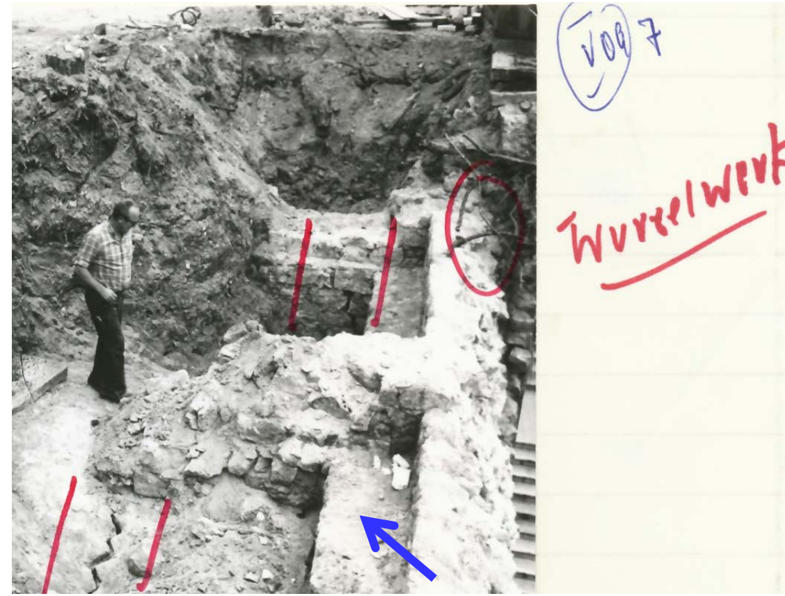
2: Aus der Baudokumentation: Als Schadensursache werden Wurzelwerk, ggf. Kriegsschäden und Witterung genannt. Die erste Mauerverbreiterung des nach unten stärker werdenden Mauerwerks ist gut zu erkennen (blauer Pfeil). Die roten parallelen Striche markieren Abrisse vom Kernmauerwerk!
