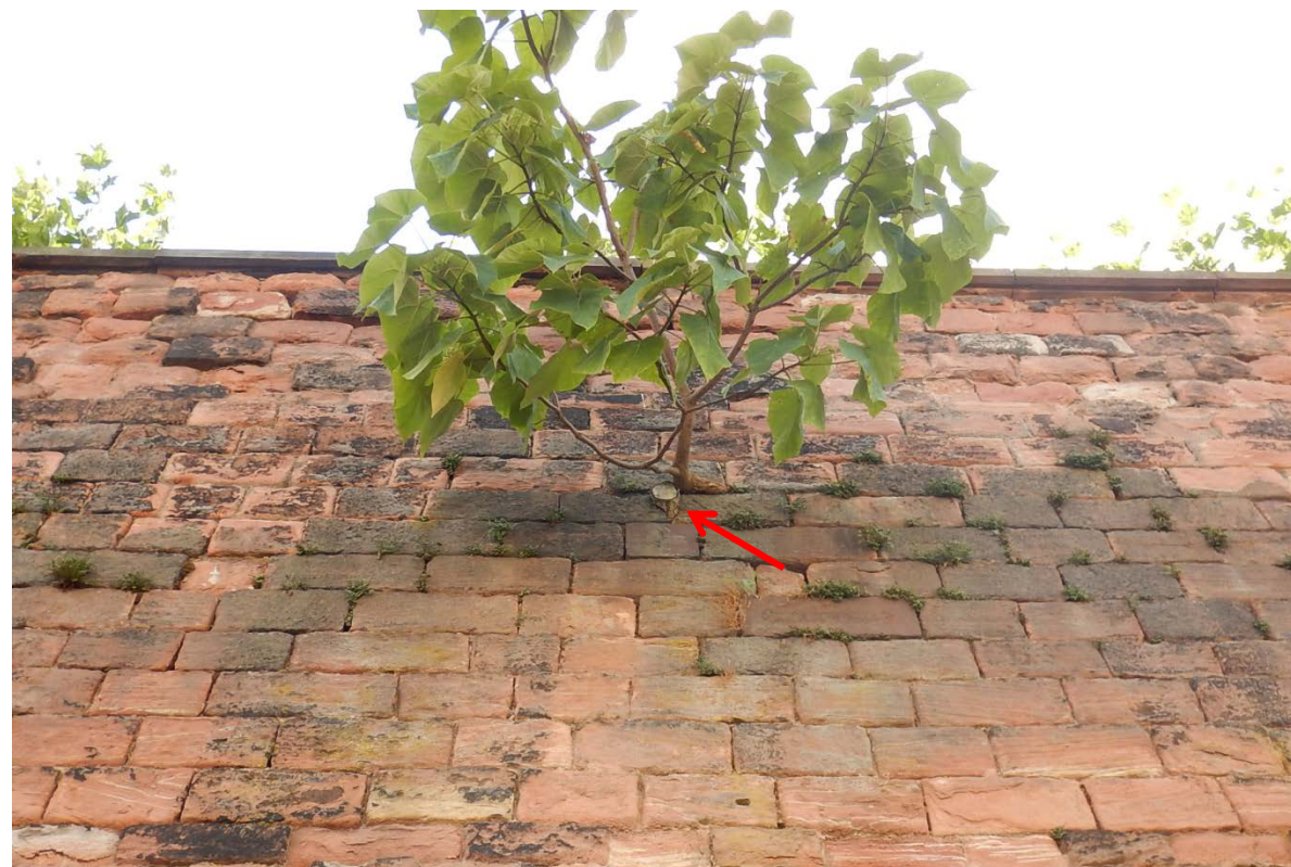
3: Bewuchs im Mauerwerk. Die Wurzel wurde nicht ausgebaut, sondern nur gekappt (roter Pfeil). Die Pflanze hat daraufhin wieder ausgetrieben.
