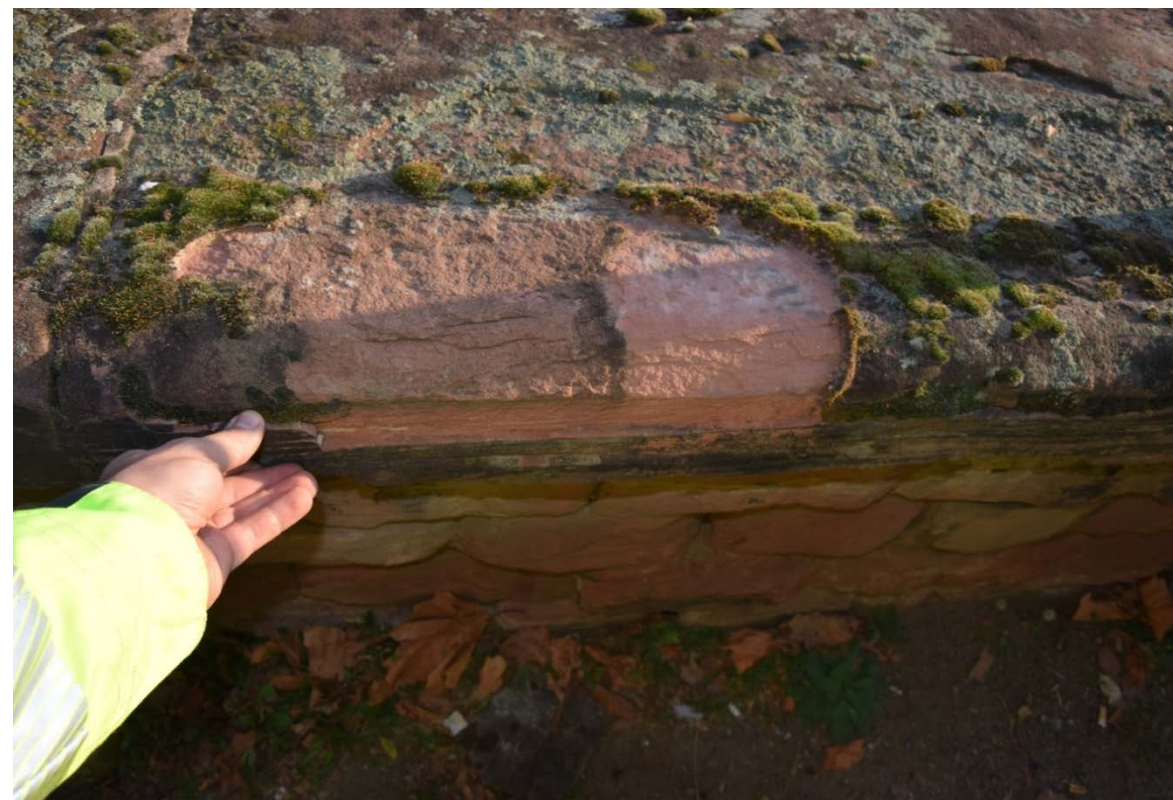
3: Mauerkrone Ostseite - Moosbewuchs und oberflächige Abplatzung an der Mauerkronenabdeckung.
