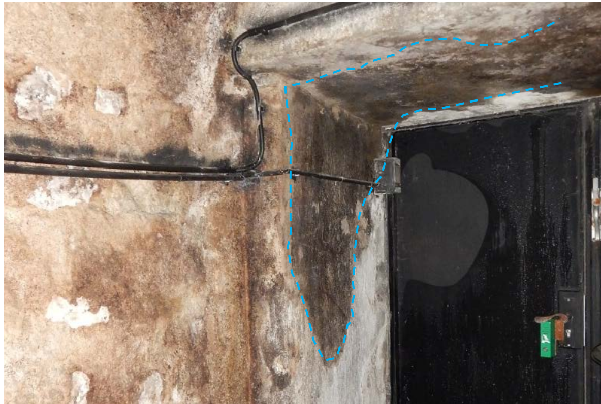
1: Flavius - Sichtbare Durchfeuchtung an der Türleibung.
