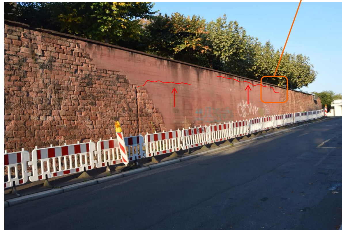
5: Der sanierte, mit Beton ausgebesserte Bereich weist über die gesamte Länge einen feinen horizontalen Riss auf.
