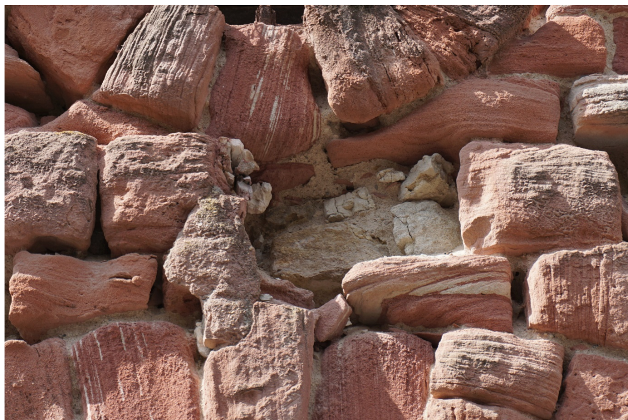
3: Einzelne Steine haben sich bereits aus dem Mauerverbund gelöst. Dahinter wird das Kernmauerwerk sichtbar.
