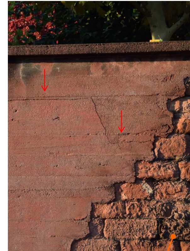
3: Horizontaler verlaufender Riss
