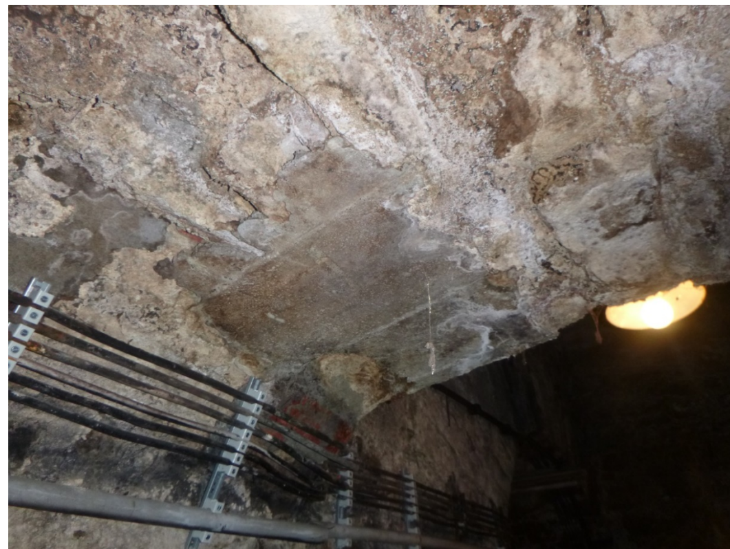
4: Treppenaufgang - Betonflickung am Treppendurchgang
