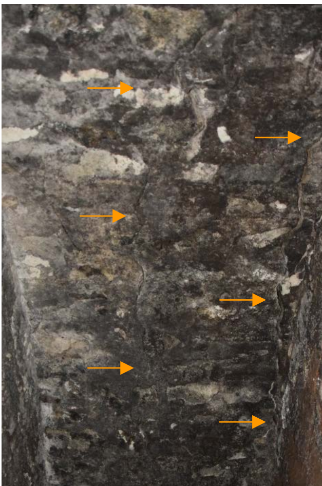
4: Zwei ca. 1 cm breite und ca. 10 cm tiefe Risse im Gewölbebogen.
