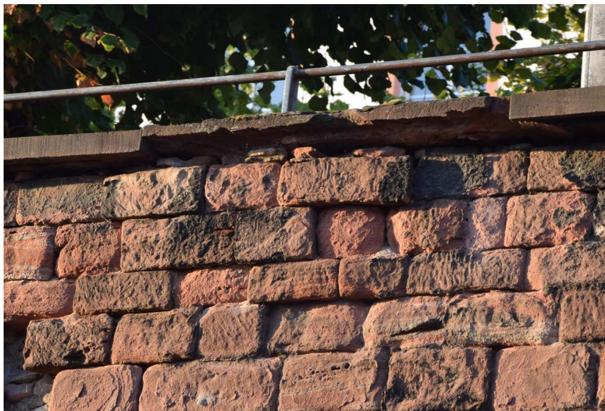
4: Stark verwitterte Oberflächen und Ausbruch an der Mauerkronenabdeckung.
