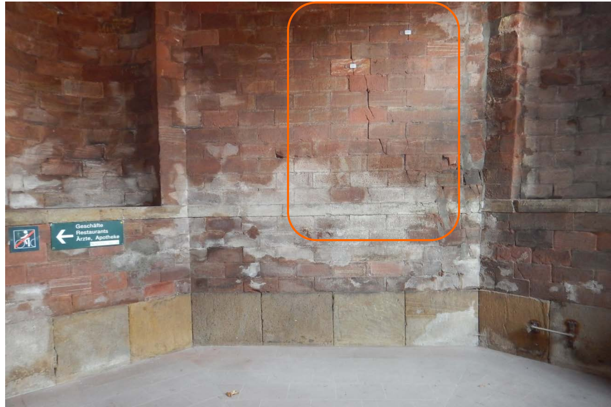
1: Oktogonhalle – Riss und Ausblühungen in der westlichen Oktogonwand (Stand 16.07.2018)
