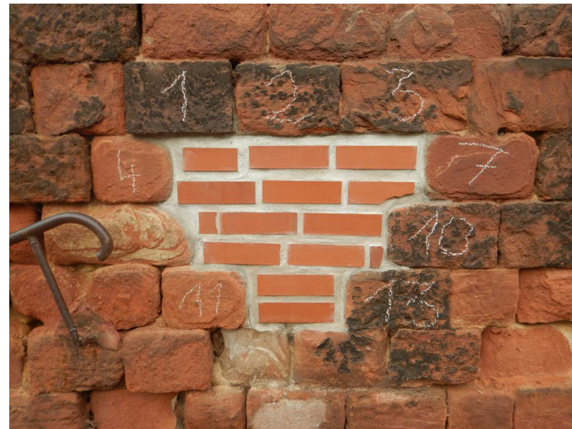
4: Treppenpodest: Nach Aufnahme der Sondierungsöffnungen und der Steine sowie der Probenentnahme durch das Institut für Steinkonservierung Mainz wurden die Sondierungsöffnungen vorübergehend kraftschlüssig zugemauert.
