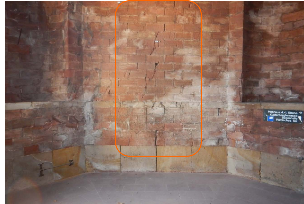
2: Oktogonhalle - Riss und Ausblühungen in der östlichen Oktogonwand (Stand 16.07.2018)
