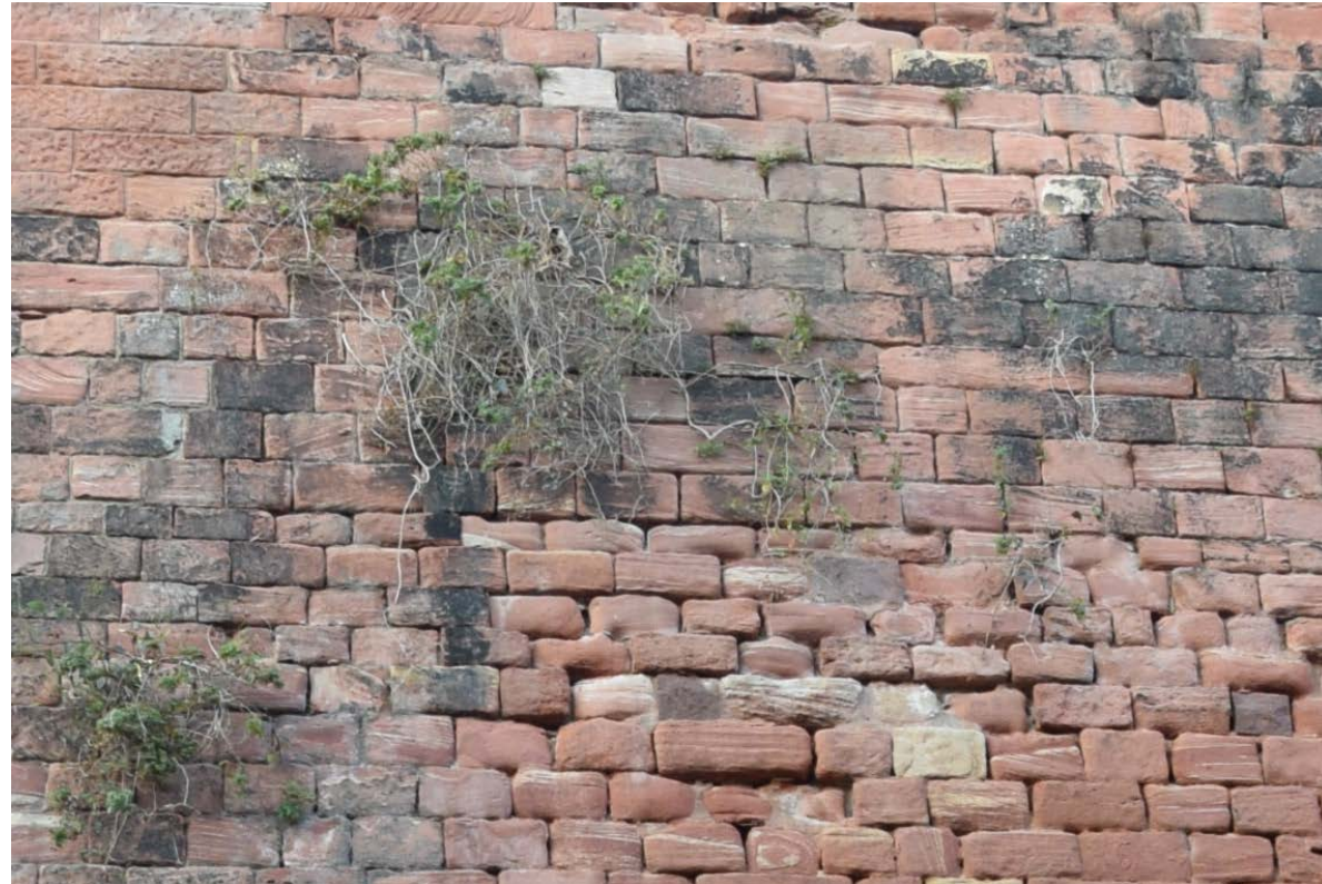
1: Neben großflächigem Moosbewuchs hat sich vereinzelt Bewuchs in den ausgewitterten Fugen des Mauerwerks gebildet.
