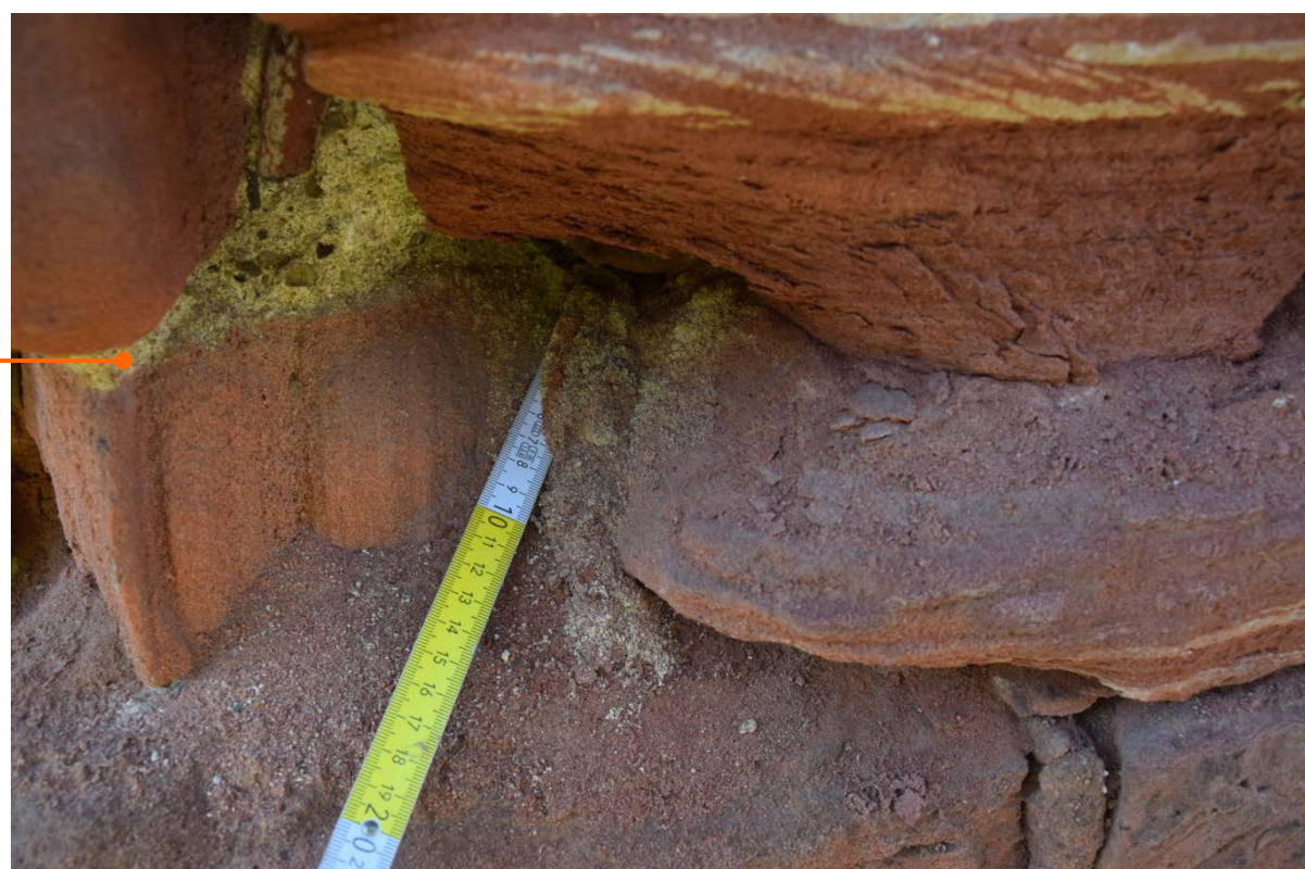
6: Starke Absandungen und bis zu 17 cm tief ausgewitterte Fugen.
