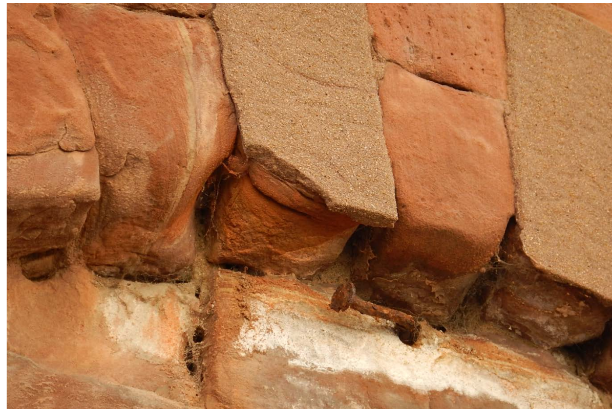
4: Nicht fachgerechte Reparatur: Der rückgewitterte Sandstein wurde mit einer Steinersatzmasse ergänzt und bröckelt ab.
