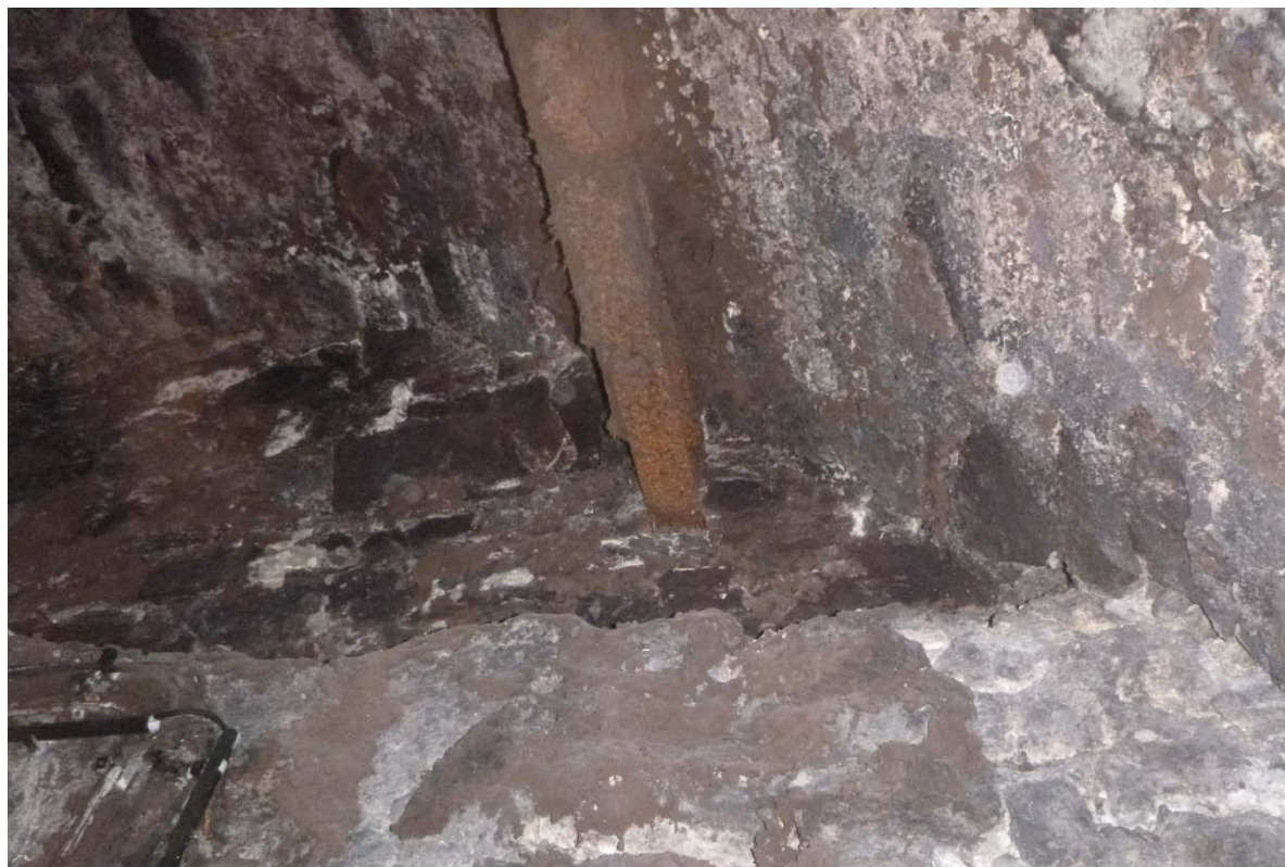
3: Keller Antonius / Brutus - Korrodierter Stahlträger
