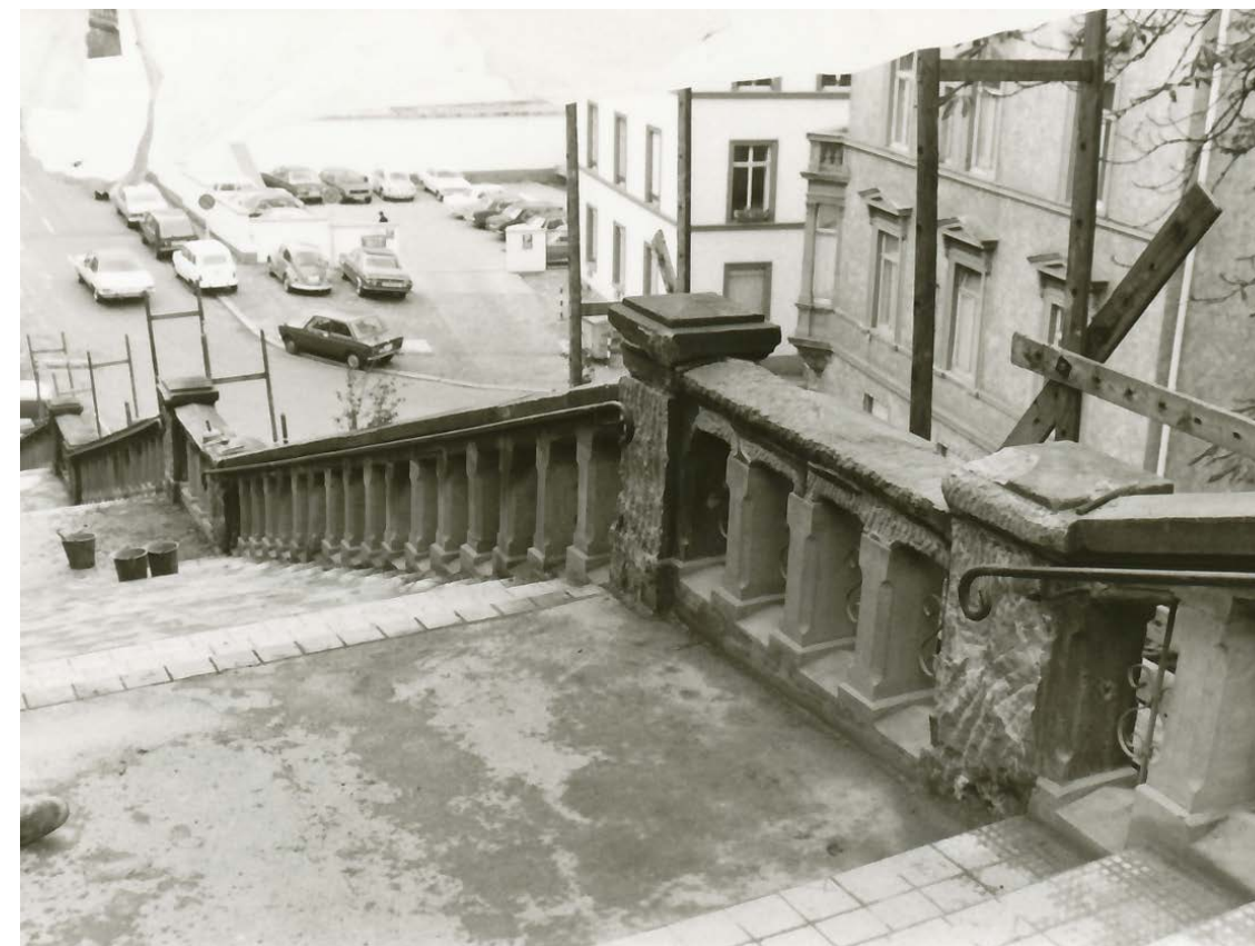
4: Aus der Baudokumentation: Die Balustrade war stark geschädigt und wurde erneuert.
