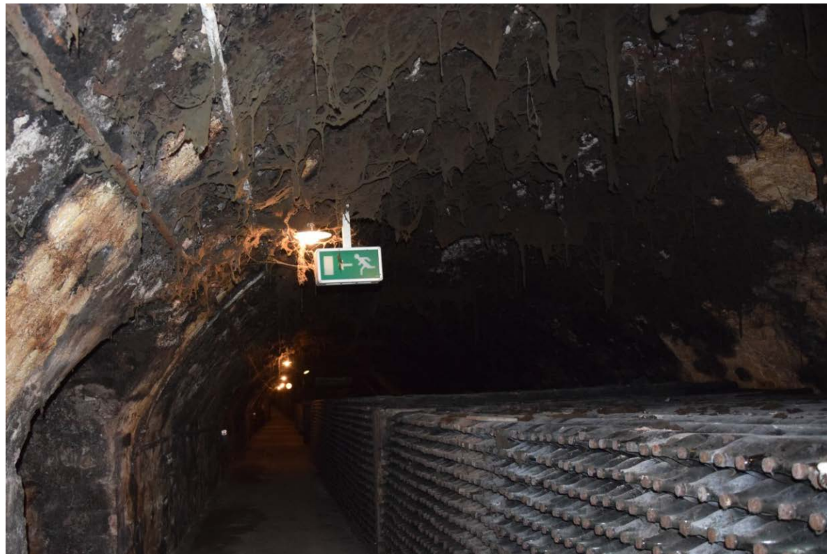
1. Von Schimmel überwuchertes Gewölbe
