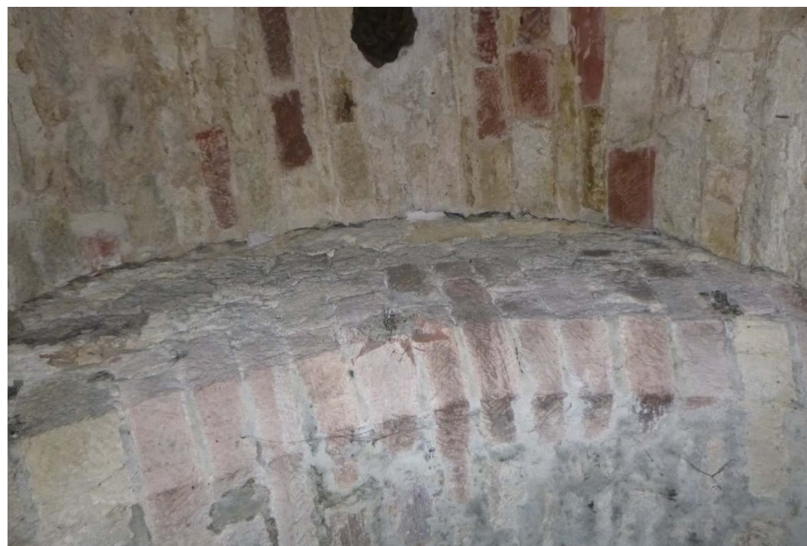
4: Leibniz - Baufuge zwischen der Stützmauer/Außenmauer und den Gewölbe.
