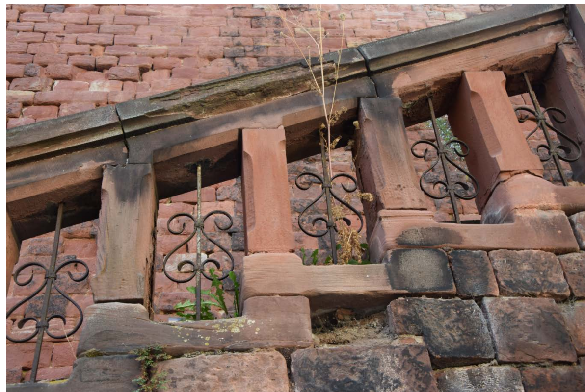
3: Geschädigtes Sandsteingeländer. Die Balustrade wurden 1975 erneuert.
