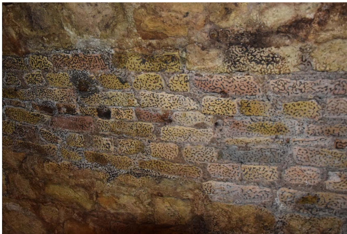
3: Germanicus Keller - Schimmelflechten im gezielten Bereich der Gewölbedecke
