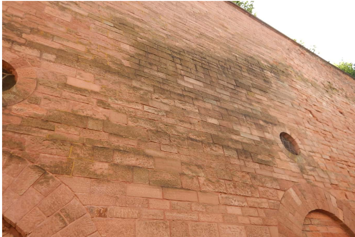
1: Nicht fachgerechte Reparatur: Die Bearbeitungsspuren an den jüngeren Steinen sind noch gut ablesbar. Das Fugennetz besteht aus ca. 1 cm breiten Stoß- und Setzfugen anstatt der ursprünglichen Haarfugen. Das Fugenmaterial wurde rot eingefärbt, um den Unterschied optisch zu kaschieren.
