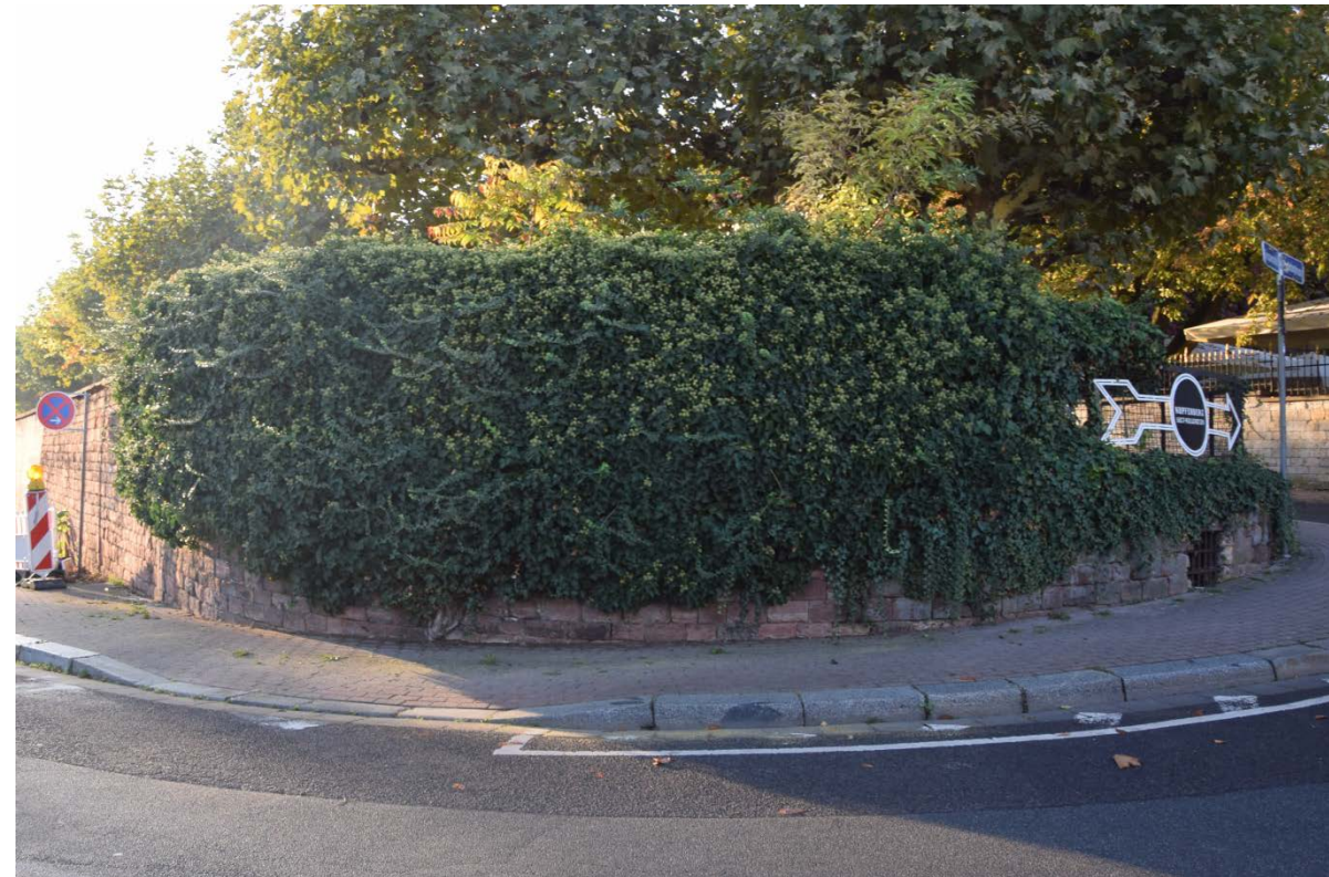
2: Großflächiger Efeubewuchs am westlichen Mauerzugende.
