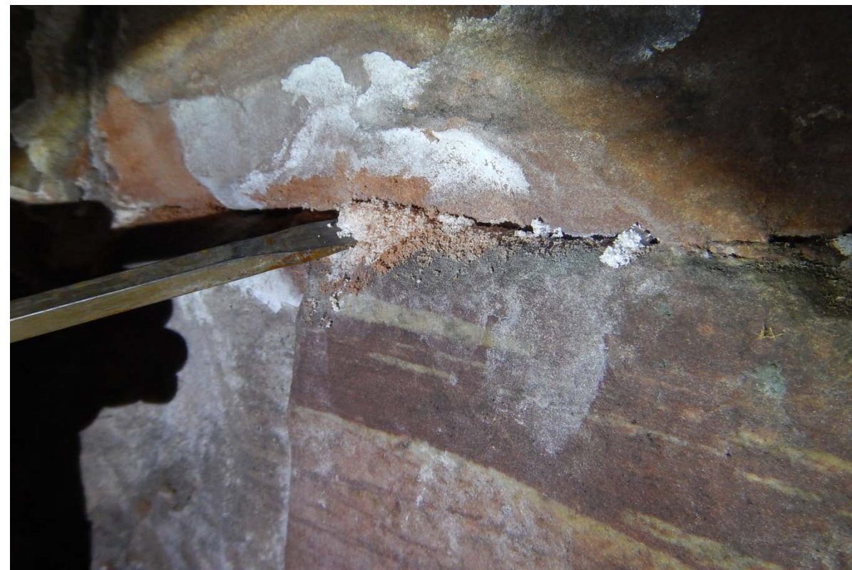
4: Detail aus dem Sockelbereich der Oktogonhalle. Das Salz blüht am Stein und in der Fuge aus.
