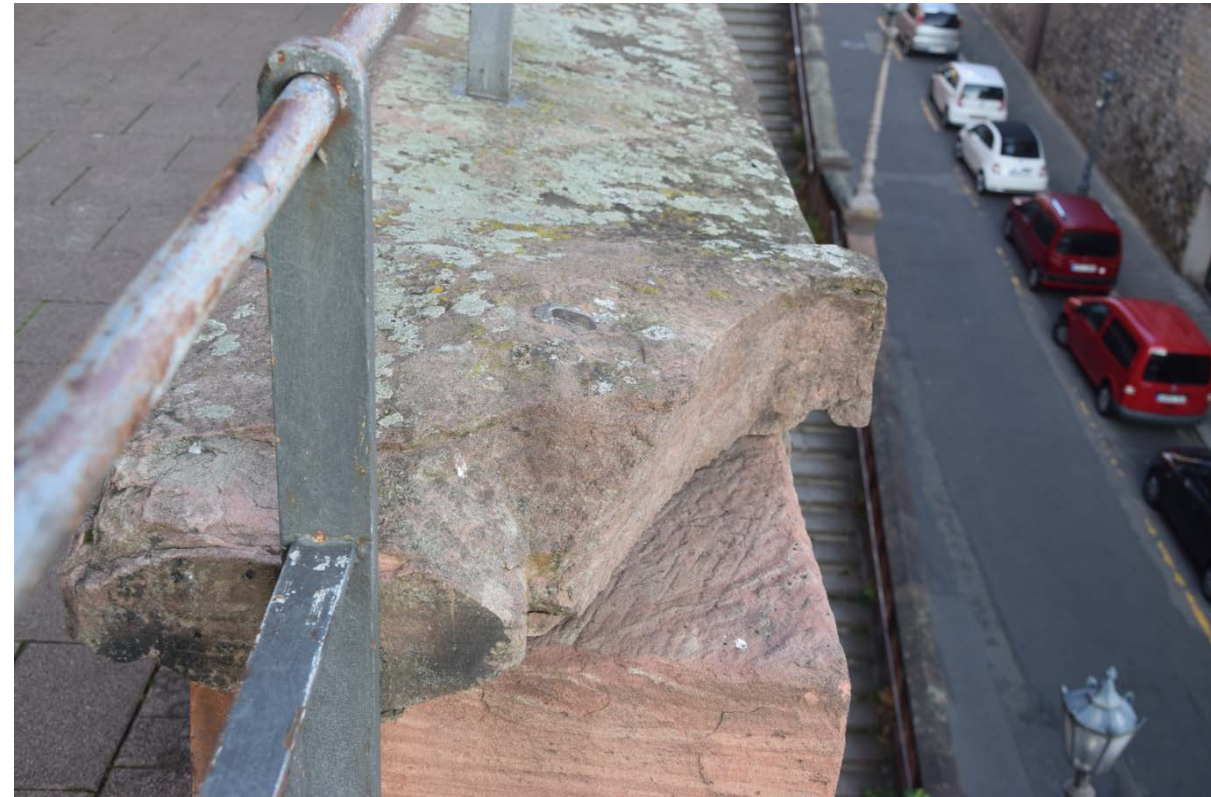
2: Mauerkrone Nordseite - großer, straßenseitiger Ausbruch an der Mauerkronenabdeckung.
