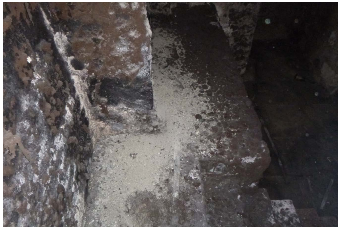
3: Franz Kupferberg – starke Absandungen im Bereich der Außenwand
