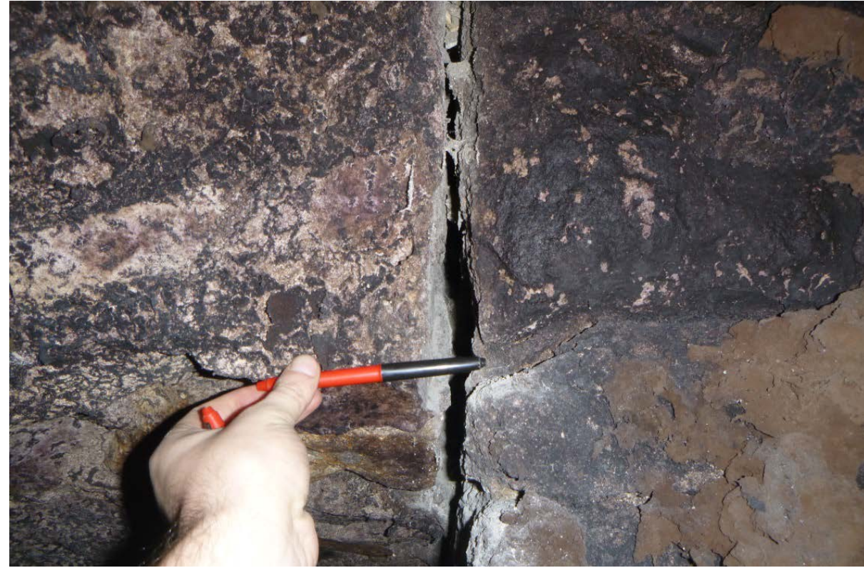
2: Franz Kupferberg - Ca. 3 cm breit aufklaffende Baufuge zwischen Gewölbe und Stützmauer.
