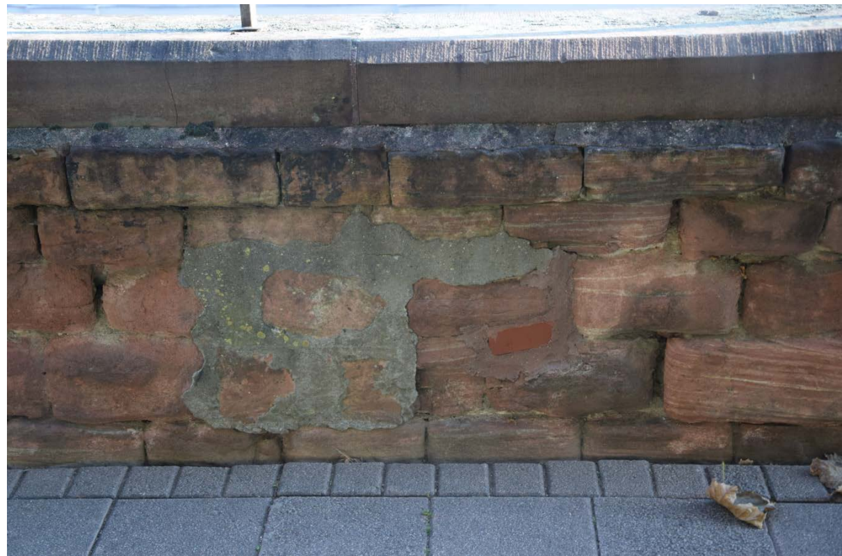
4: Mauerkrone Ostseite - stark ausgewitterte, teils mit Zementputz ausgebesserte Fugen.
