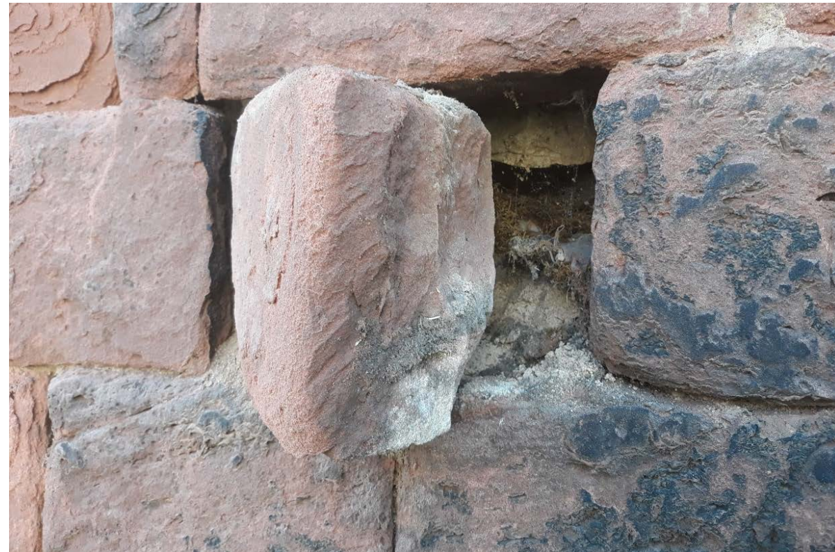
2: Einzelne lose Sandsteinquader. Der entfestigte Fugenmörtel ist stark ausgewaschen.
