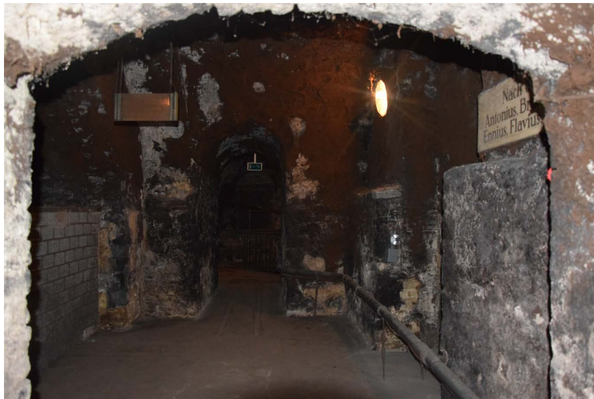
4: Aufgrund der großflächig, vom schwarzen Kellerschimmel („cladosporium cellare“) überwucherten Flächen, sind viele Bereiche des Mauerwerks nicht einsehbar.
