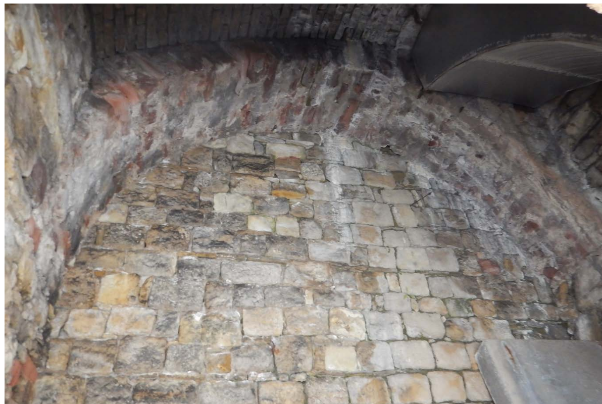
3: Blick in den Raum unter dem zweiten rechten Treppenpodest. Das niederschlaggeschützte Mauerwerk ist mit einer Salzkruste überzogen.
