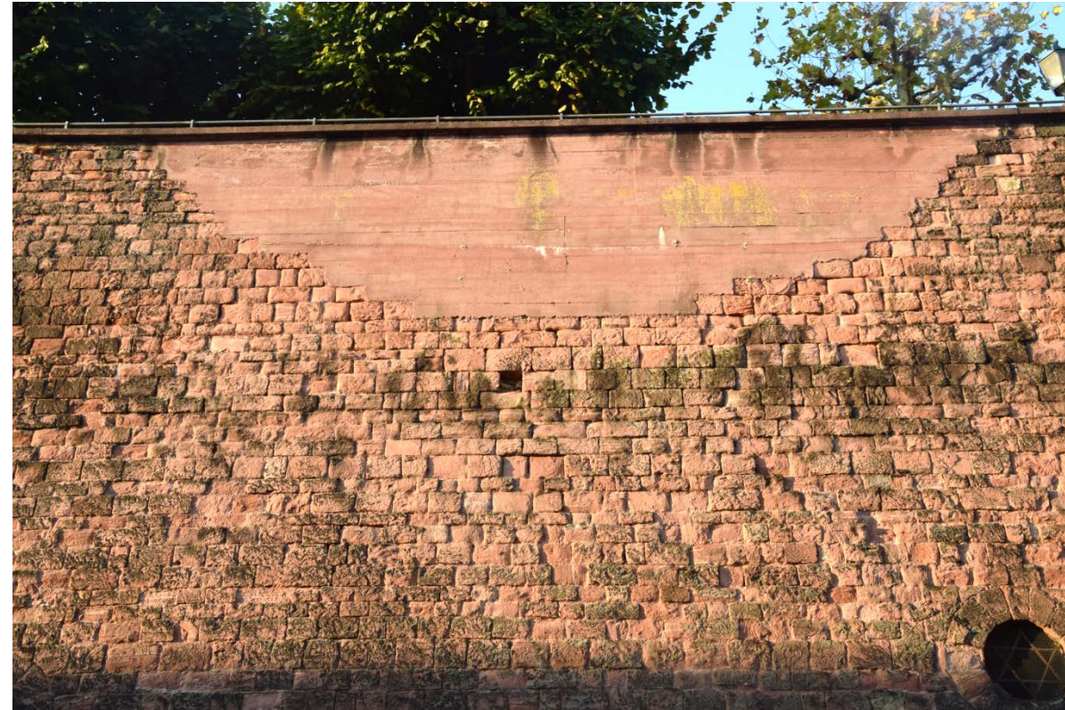
2: Nicht fachgerechte Reparatur: Der Ausbruch wurde mit eingefärbten Beton zubetoniert. Die Abdrücke der Schalbretter sind noch erkennbar.
