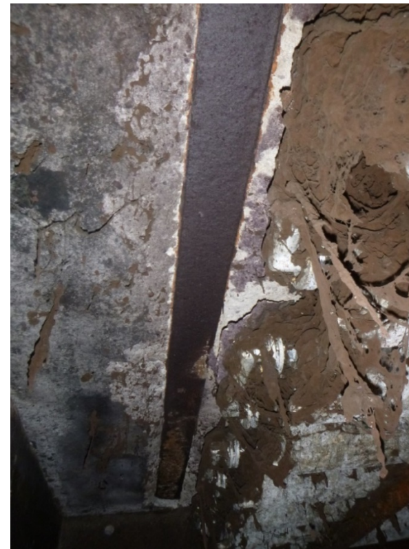
4: Korrodierter Eisenträger in Betondecke des unteren Raumes.
