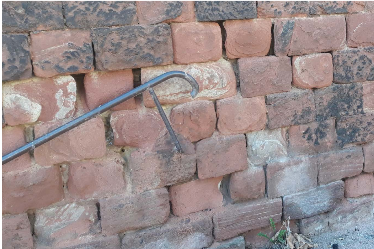
1: Stark ausgewaschene Fugen und lose Mauersteine ohne Verbund zum Kernmauerwerk.
