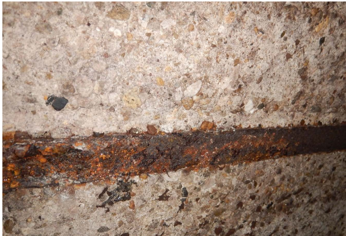
3: Stark korrodierter Eisenträger an der Unterseite des Betonbodens.
