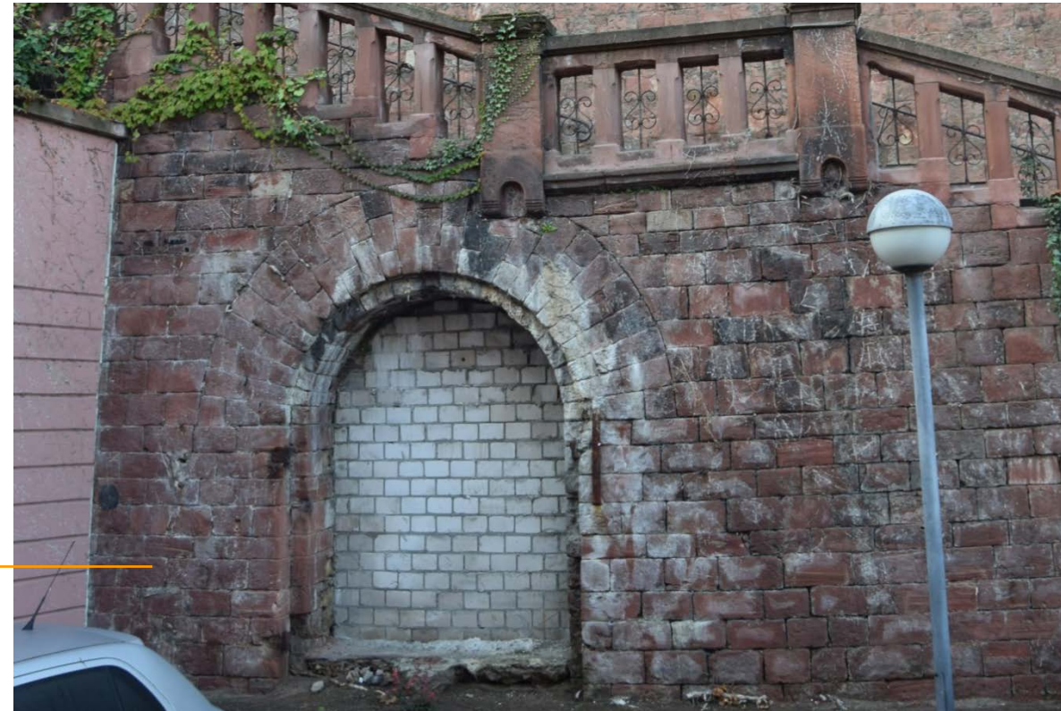
2: Zugemauerter Zugang unterhalb des Treppenaufgangs. Der dahinter liegende Kellerabschnitt ist nicht zugänglich.
