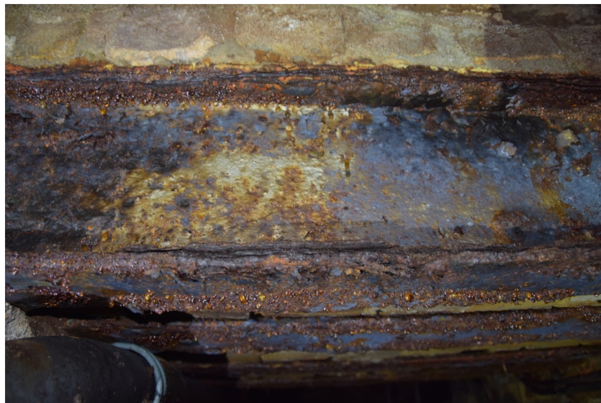
4: Germanicus Keller – Treppenabgang, stark korrodierte Eisenträger
