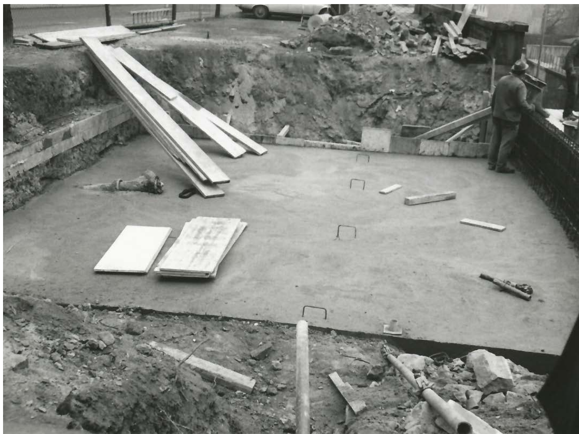
3: Aus der Baudokumentation: Der Gewölbezwickel wurde mit Magerbeton aufgefüllt und darüber die hier sichtbare Betonplatte gegossen. Rechts die Armierung für den „oberen Abschlussbalken“
