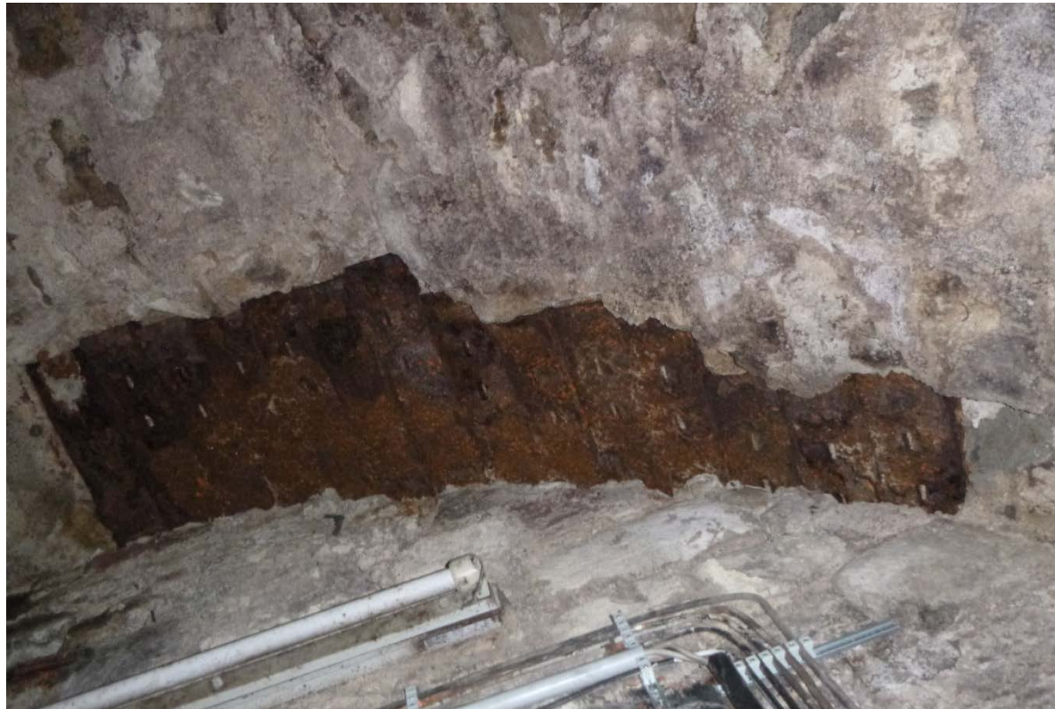
1: Drusus - Korrodierte Eisenschalung(?) in der Gewölbedecke.
