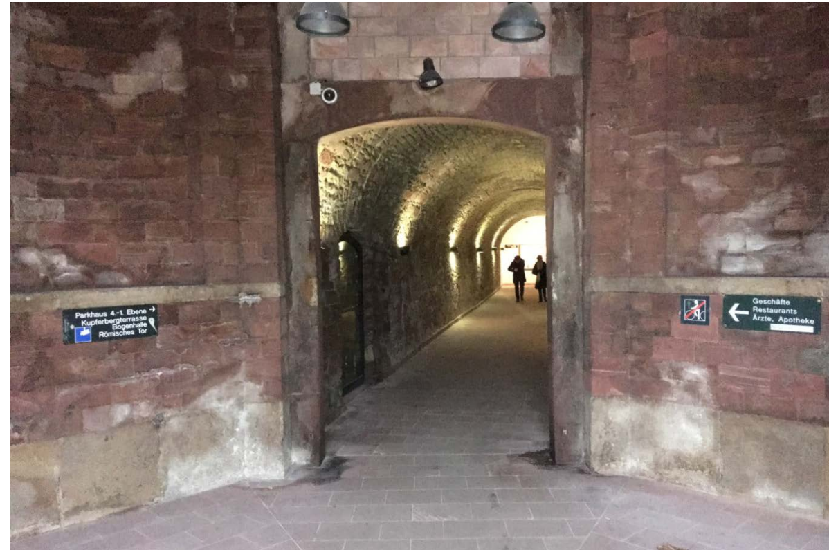
2: Oktogon vor der Notsicherung (Stand 20.12.2017) und Zugangstunnel zum Parkhaus.
