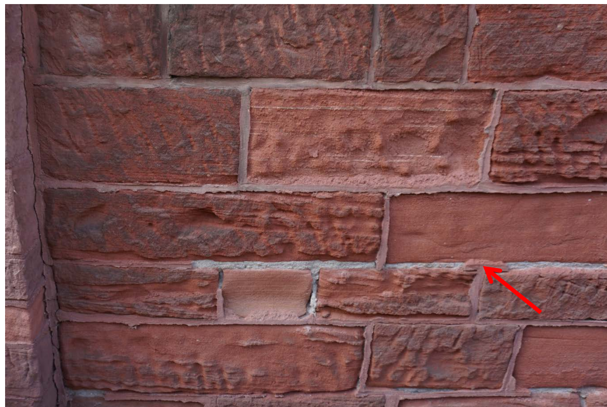
3: Nicht fachgerechte Reparatur: Rot eingefärbter zementöser Deckfugenmörtel. Die Setz- und Stoßfugen sind deutlich breiter als die Haarfugen der original Sandsteinschale. Das Fugenmaterial löst sich, da die Steine rückwittern und damit die Steinflanken des Fugenmörtels wegfallen.
