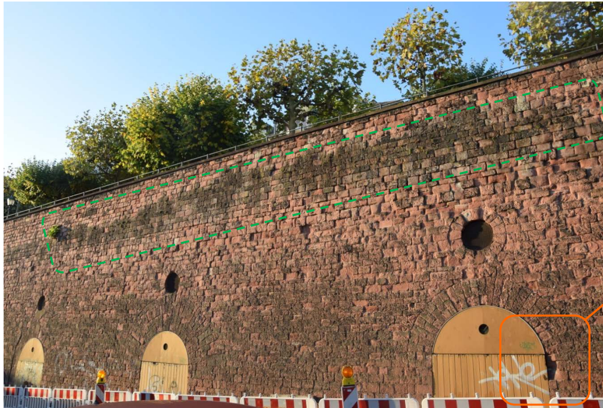
1: Moosbewuchs; verwitterte Oberflächen und Ausbrüche in den Torlaibungen.
