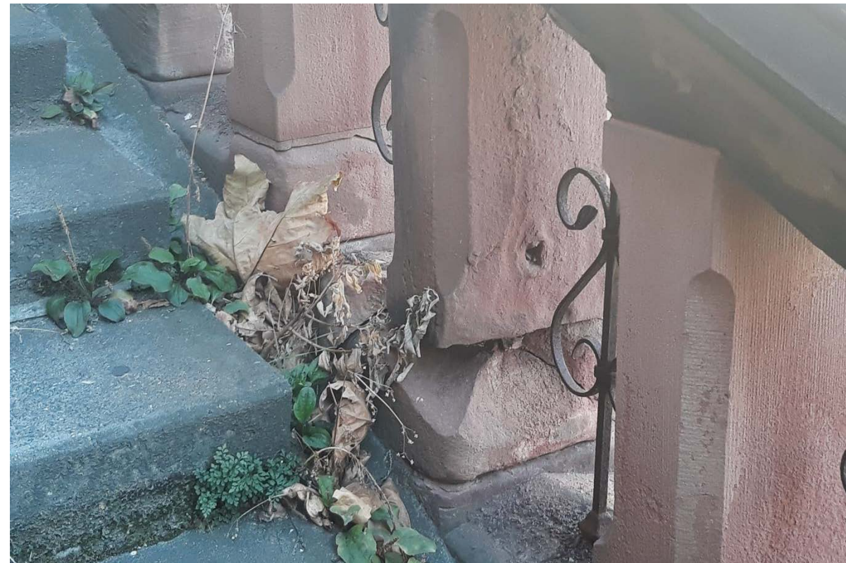
4: Ausbruch am Balustersockel.
