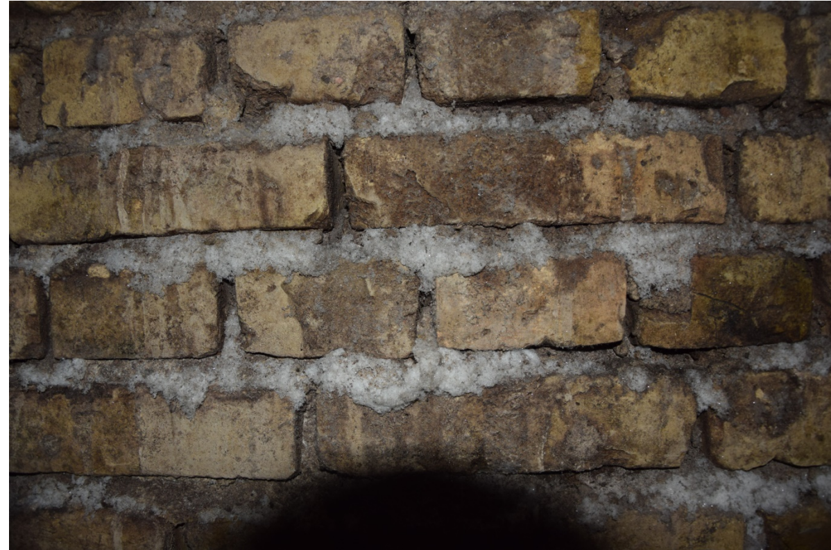
3: Starke Salzausblühungen (bis 2,5 m Höhe) in den Fugen des mit Ziegeln aufgemauerten Bereiches.
