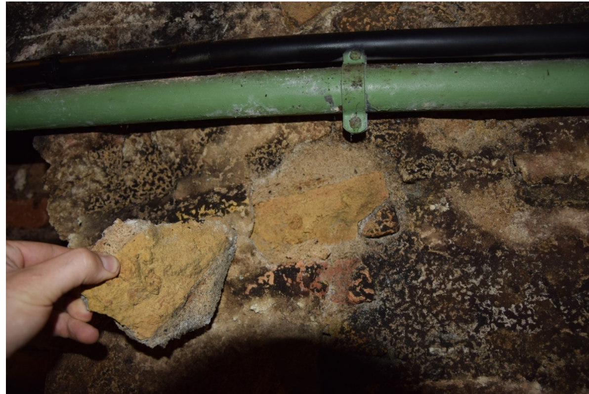
2: Flavius Keller - Brüchiger, leicht zu lösender Mörtel und Putz.
