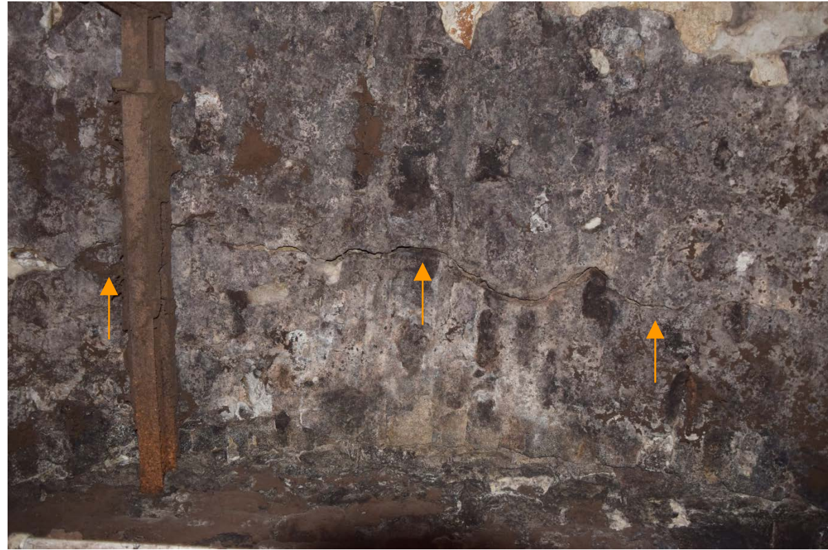
3: Antonio Brutus - In Querrichtung verlaufender Riss in der Gewölbedecke des Kellers
